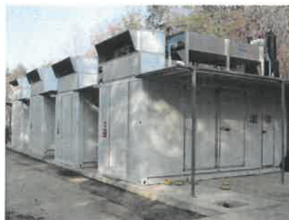
Impianto di recupero energetico biogas
