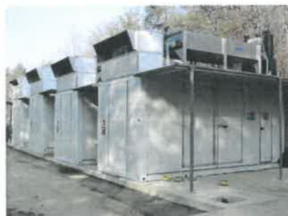
Impianto di recupero energetico biogas
