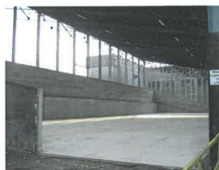
Area per la triturazione del legno trattato
