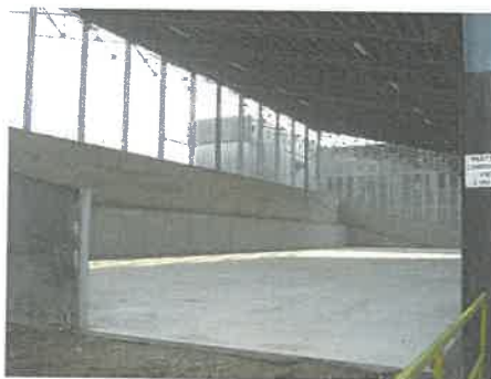
Area per la triturazione del legno trattato
