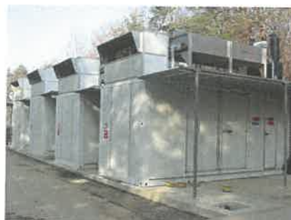
Impianto di recupero energetico biogas
