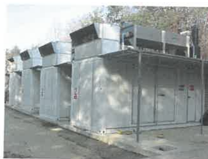
Impianto di recupero energetico biogas
